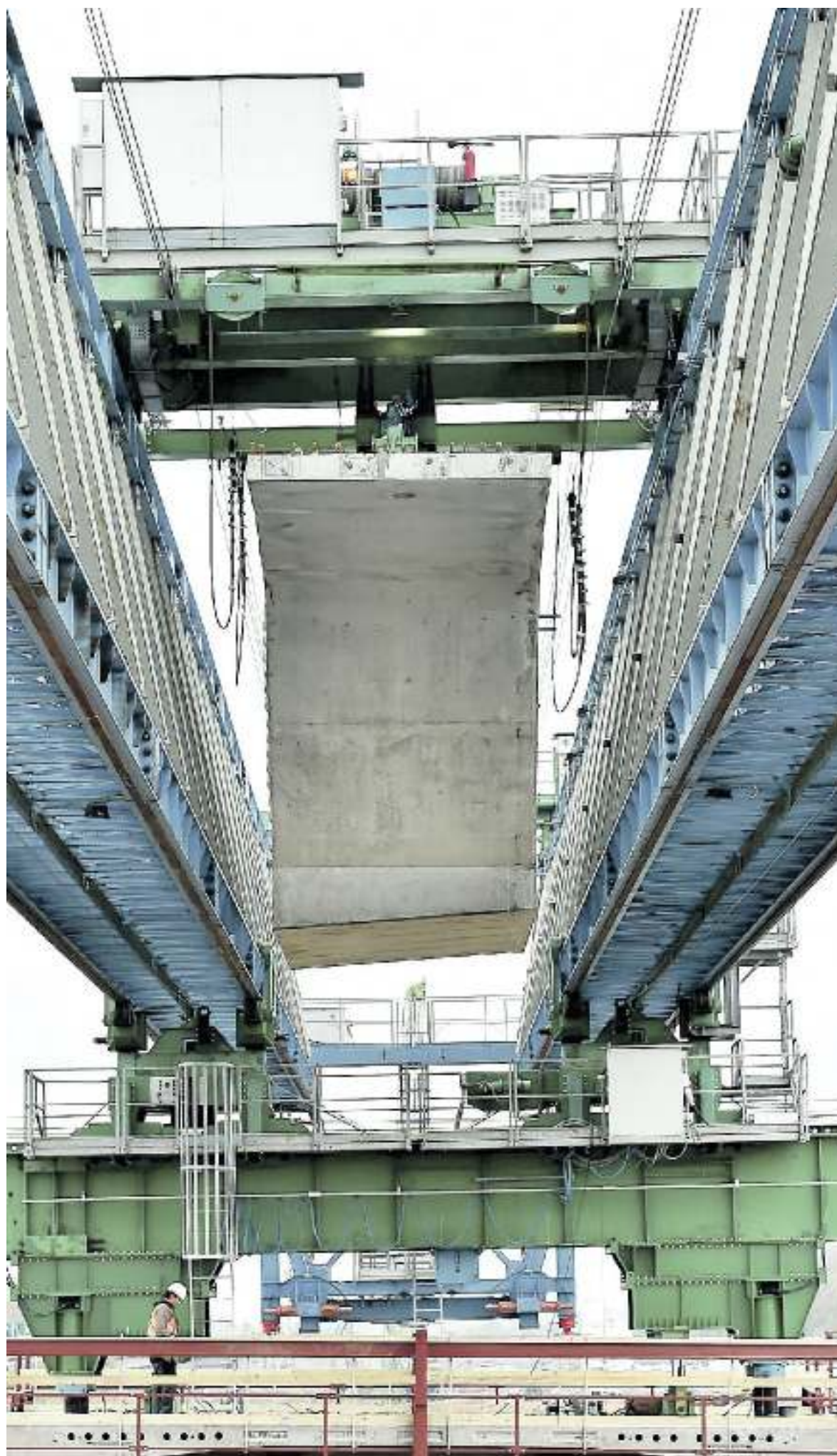
TERZA CORSIA I lavori proseguono sull'asse da Portogruaro allo snodo fra la A4 e la A23
